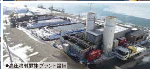
●高圧噴射攪拌 プラント設備
